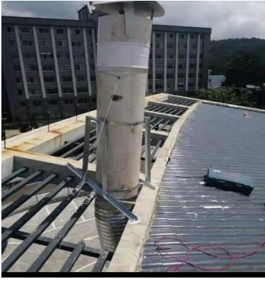
废气净化及外排设施
